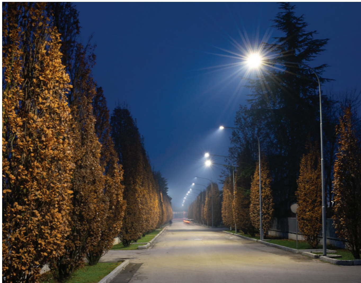
oprawy uliczne / street lighting
